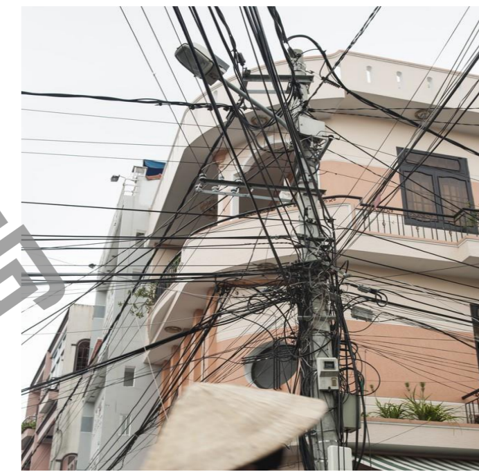
杂乱无章的电力杆线
